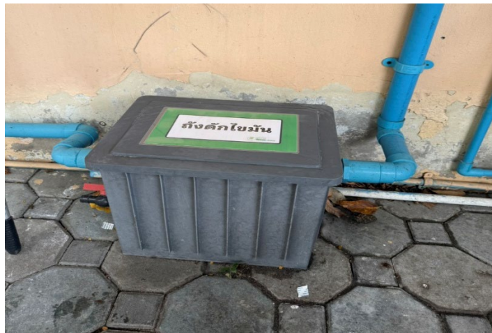
ถังดักไขมัน ห้อง 104 อ่างล้างจาน ชั้น 1
