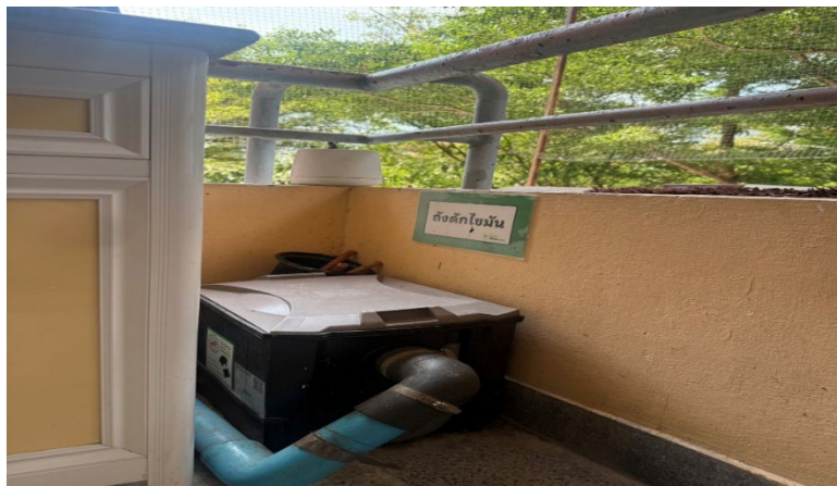
ถังดักไขมันห้องรับประทานอาหารอ่างล้างจาน ชั้น 2
