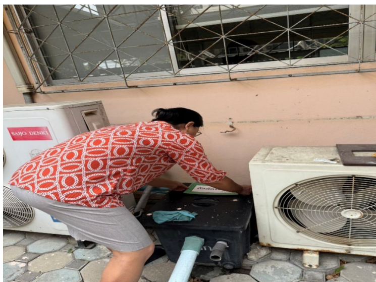
ถังดักไขมันห้อง 108 อ่างล้างจาน ชั้น 1
