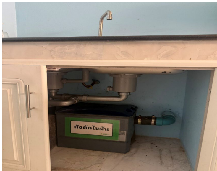
ถังดักไขมันบริเวณห้องครัวอ่างล้างจาน ชั้น 7
