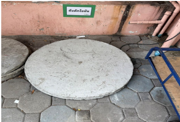
ถังดักไขมันห้องครัวอ่างล้างจาน ชั้น 1
